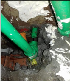
Figura 6: Erro de termofusão 1
