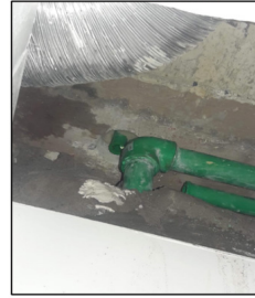
Figura 7: Erro de termofusão 2
