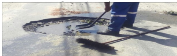
Figura 7: Buracos, cavidade ou panelas
