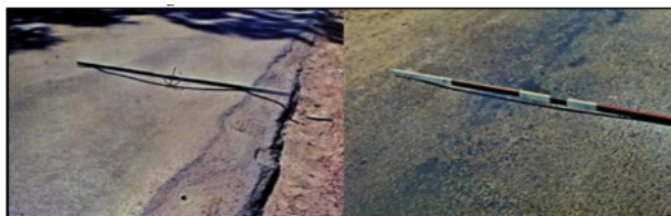
Figura 3: Afundamento de trilha de roda e afundamento local.
