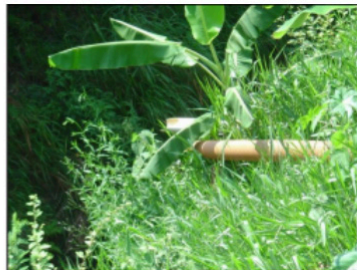
Figura 4: Saída de esgoto in natura da em ETE no Rio Ubá/Paty do Alferes
