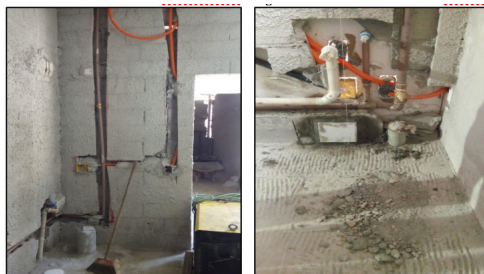
Figura 8: Interferência do sistema hidrossanitário Figura 9: Interferência do sistema hidrossanitário
