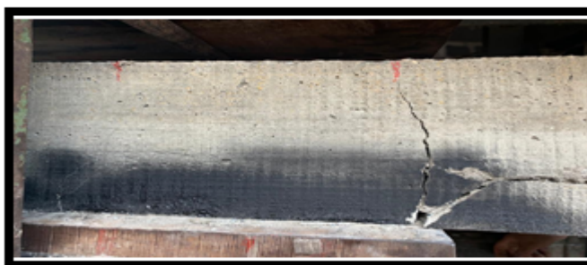
Figura 35 - Caracterização da fissuração do prisma P1
