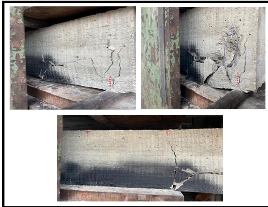
Figura 26 - Múltiplas fissuras (P1)
