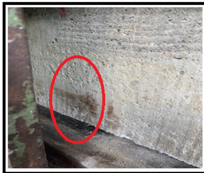
Figura 27 - Primeira fissura (P2)
