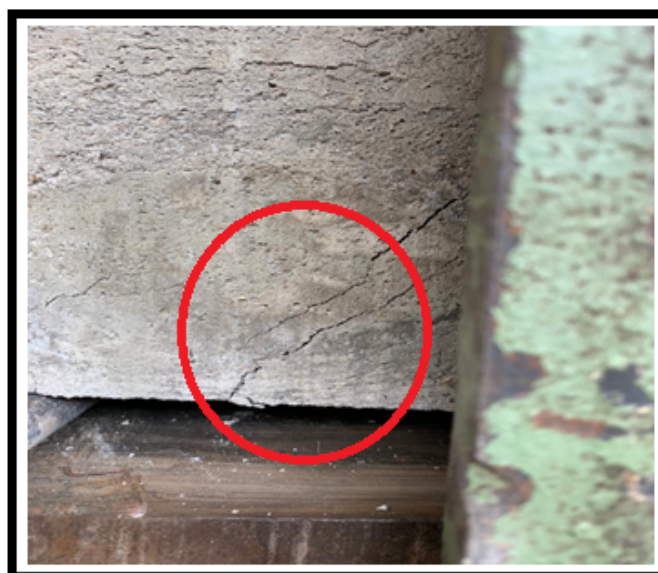
Figura 31 - Primeira fissura (P4)
