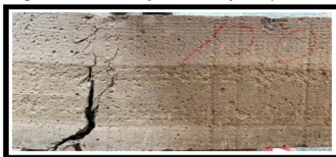
Figura 39 - Caracterização da fissuração do prisma P5
