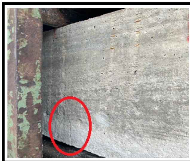
Figura 29 - Primeira fissura (P3)
