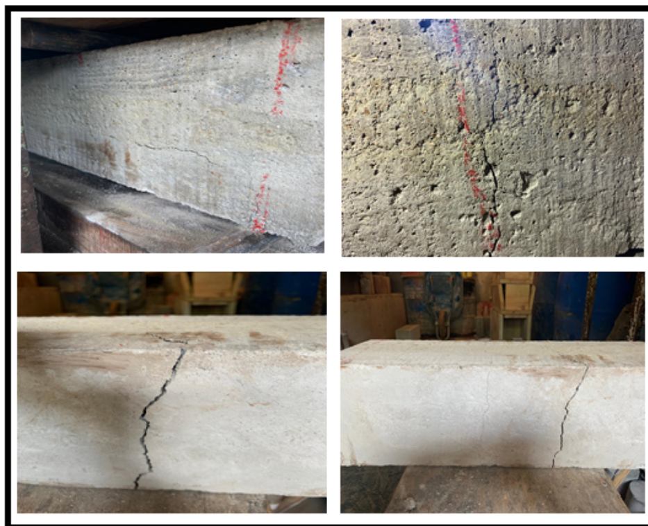
Figura 28 - Múltiplas fissuras (P2)
