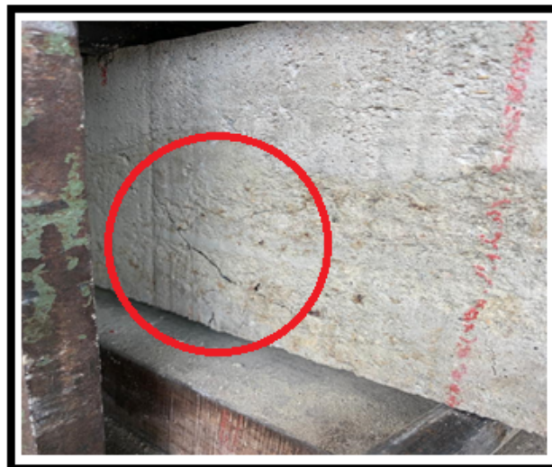
Figura 33 - Primeira fissura (P5)
