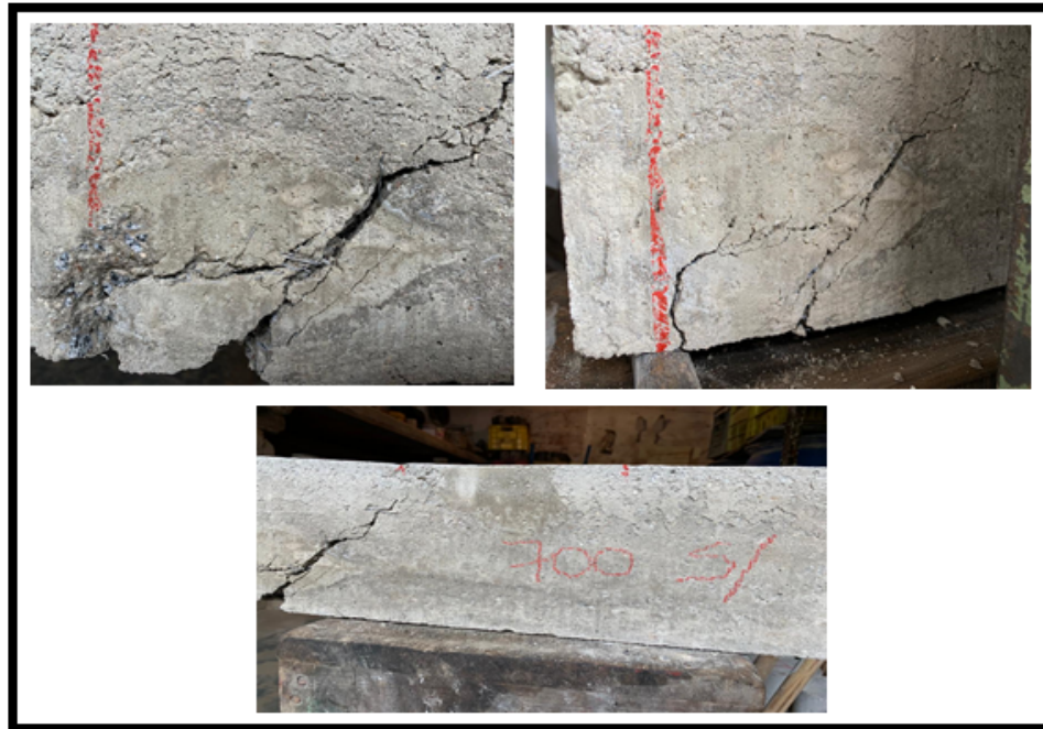
Figura 32 - Múltiplas fissuras (P4)
