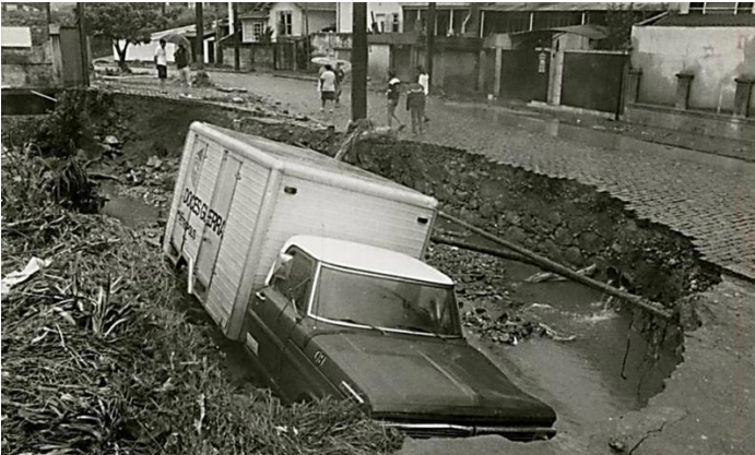
Foto3: Caminhão foi engolido por cratera na Rua Souza Franco no Centro de Petrópolis fev.1988 Foto Guilherme Pinto/Agência Globo– 06/02/1988.
