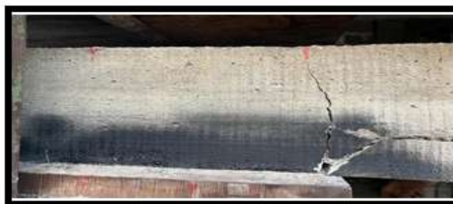
Figura 35 - Caracterização da fissuração do prisma P1
