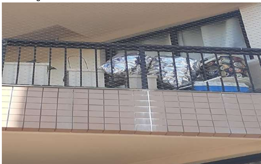
Figura 5 – Eflorescência na fachada do condomínio Four Seasons
