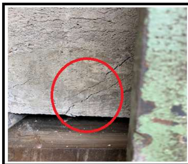
Figura 31 - Primeira fissura (P4)
