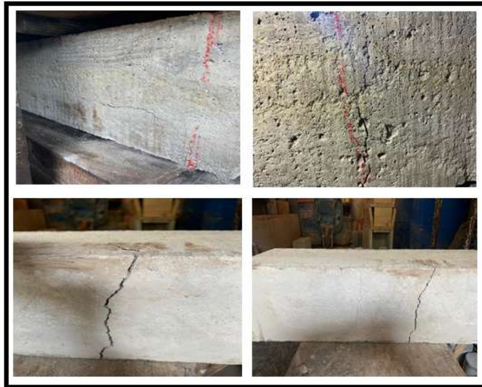
Figura 28 - Múltiplas fissuras (P2)
