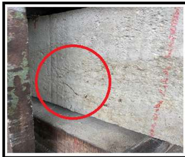
Figura 33 - Primeira fissura (P5)
