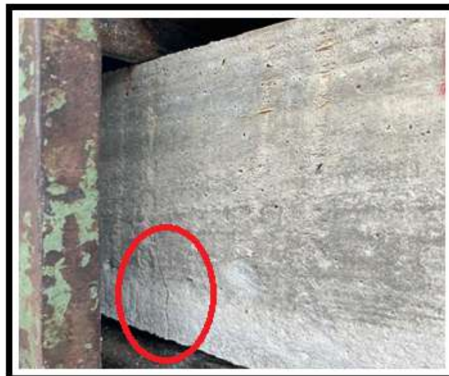
Figura 29 - Primeira fissura (P3)
