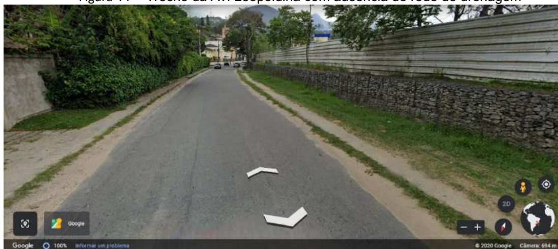
Figura 11 – Trecho da Av. Leopoldiana com ausência de rede de drenagem
