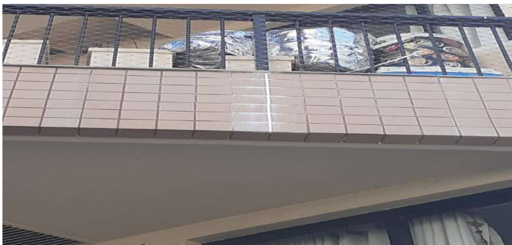
Figura 23: Processo de eflorescência, caracterizando percolação de água pelo pontalete
