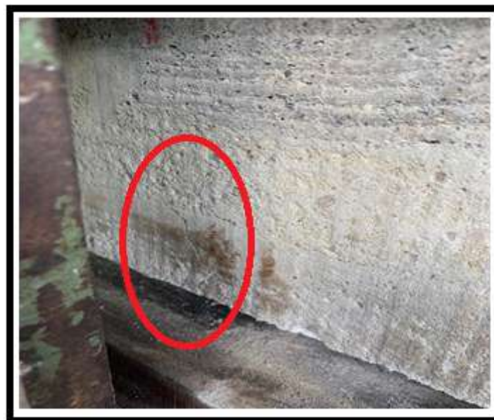
Figura 27 - Primeira fissura (P2)
