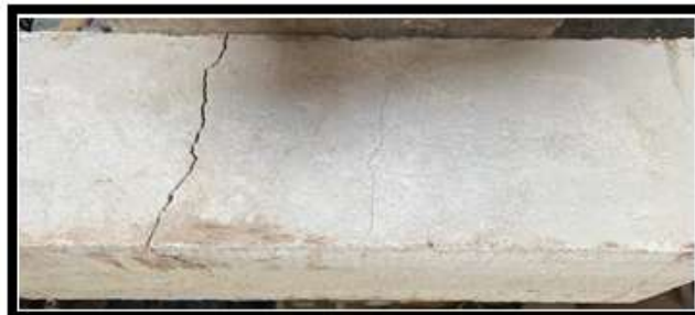
Figura 36 - Caracterização da fissuração do prisma P2
