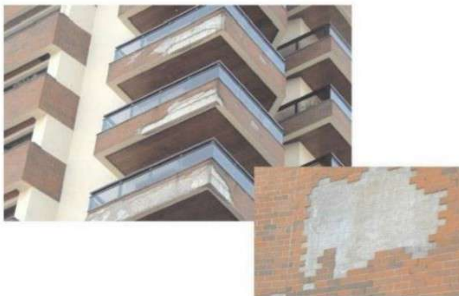
Figura 3 – Descolamento de cerâmicas em fachada
