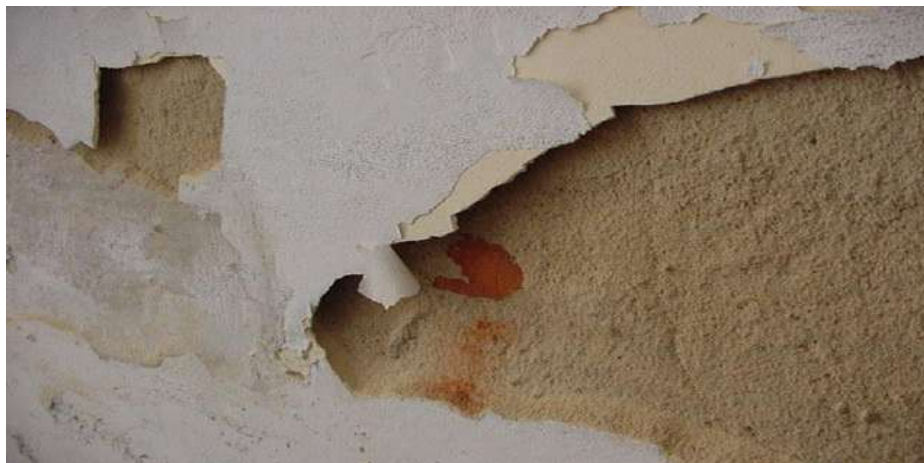
Figura 7 – Subeflorescência em fachada
