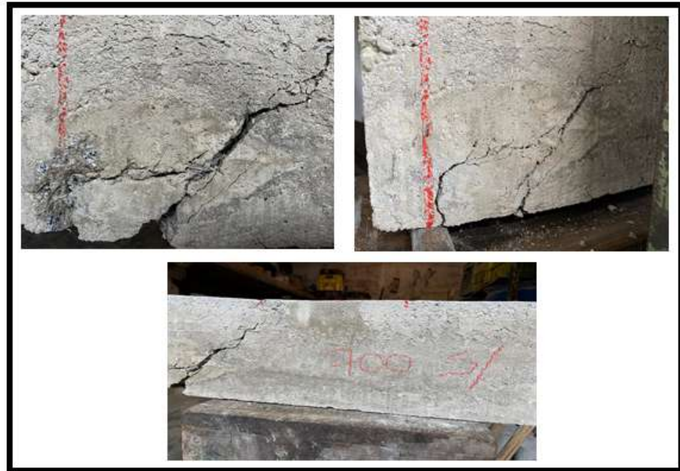
Figura 32 - Múltiplas fissuras (P4)
