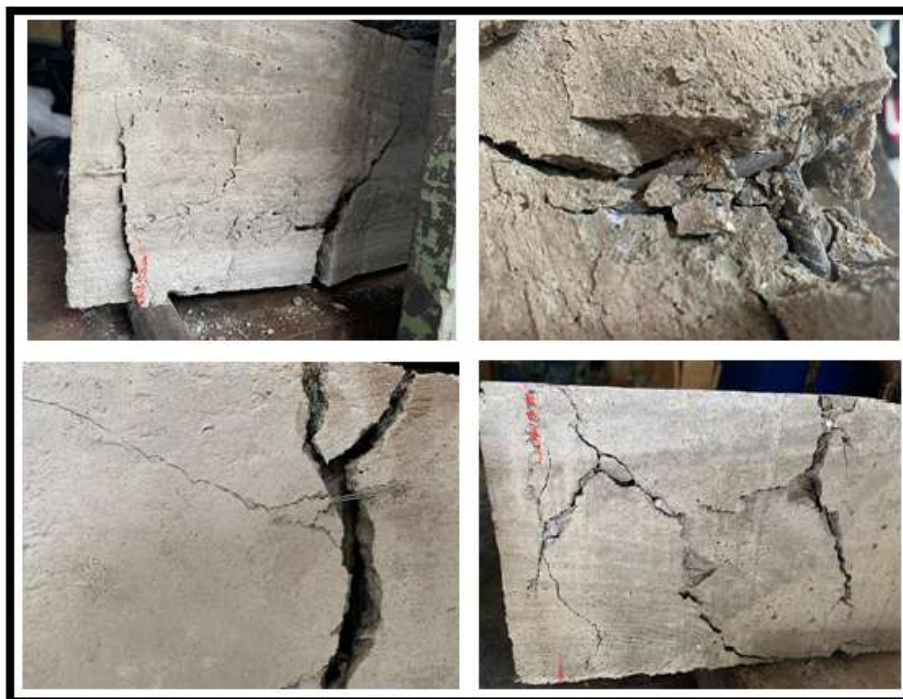
Figura 30 - Múltiplas fissuras (P3)
