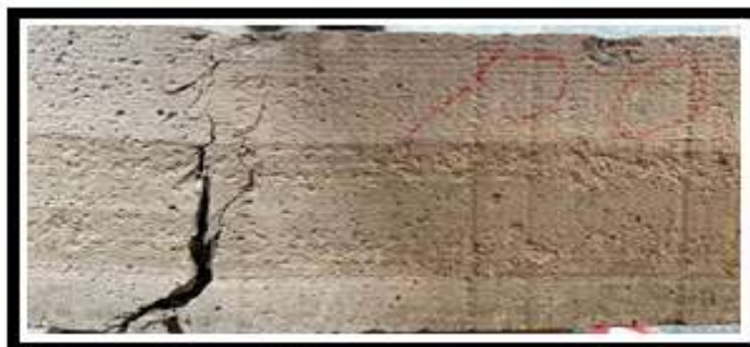
Figura 39 - Caracterização da fissuração do prisma P5
