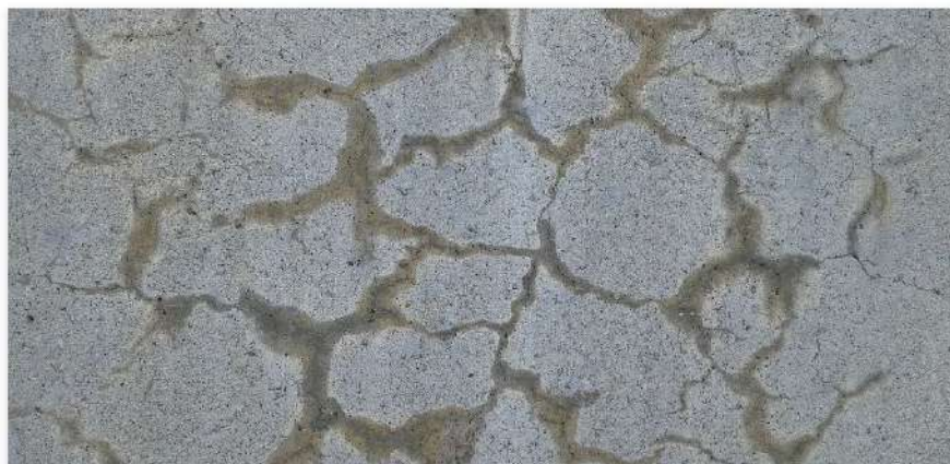
Figura 9 – Concreto em processo de carbonatação
