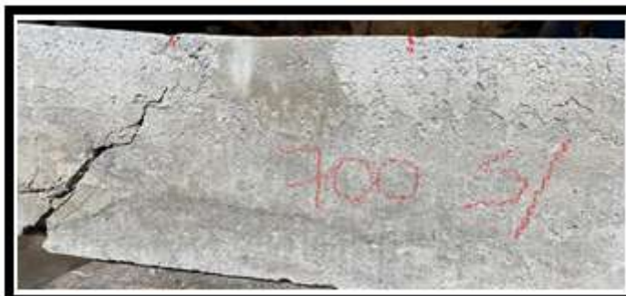
Figura 38 - Caracterização da fissuração do prisma P4
