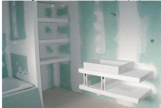
Figura 16 - Placa de gesso acartonado verde (RU), aplicada no banheiro
