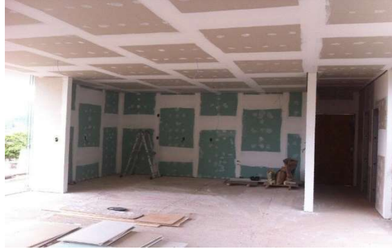
Figura 15 - Placa de gesso acartonado verde (RU), aplicado na cozinha
