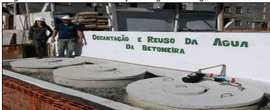
Figura 18 – Sistema de decantação de água de lavagem de betoneiras
