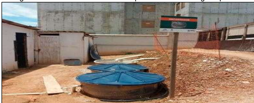
Figura 17 – Sistema de coleta e reaproveitamento de águas pluviais
