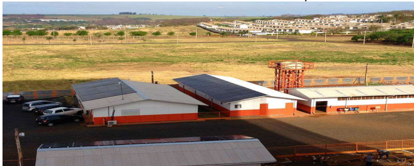
Figura 25 – Placas solares instaladas nos telhados das áreas de apoio e vivência de canteiro de obra
