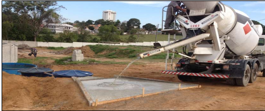
Figura 19 – Sistema de captação de água de lavagem de betoneiras
