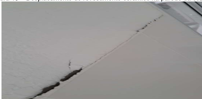
Figura 19 – Deslocamento do revestimento cerâmico na parede da cozinha
