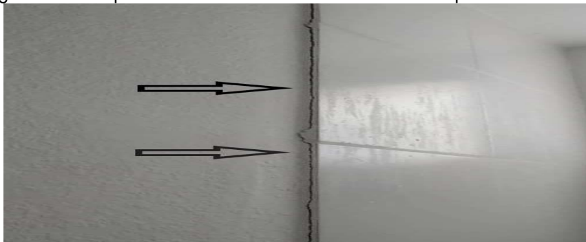
Figura 18 – Deslocamento do revestimento cerâmico na parede do banheiro
