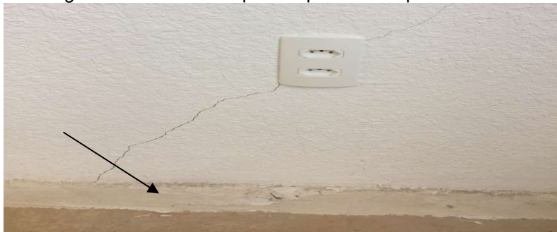
Figura 24 – Fissura na parede partindo do ponto elétrico
