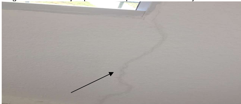
Figura 26 – Infiltração pela fissura próximo ao vão da janela da sala
