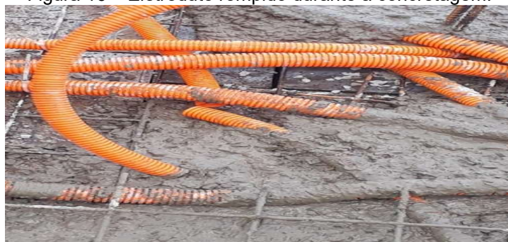
Figura 16 – Eletroduto rompido durante a concretagem.
