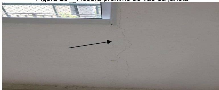
Figura 20 – Fissura próximo ao vão da janela
