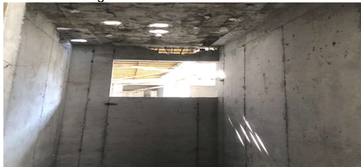
Figura 11 – Bicheira na estrutura
