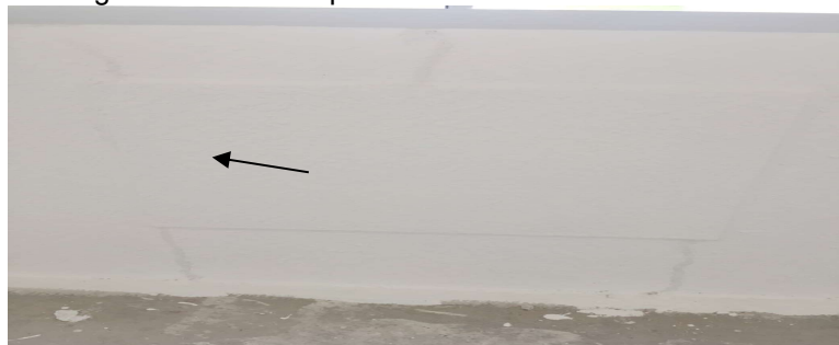
Figura 21 – Fissura próximo ao vão do ar-condicionado
