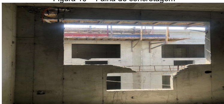
Figura 10 – Falha de concretagem
