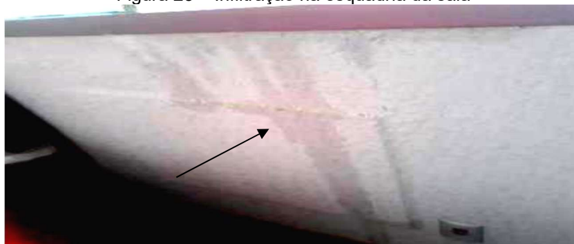
Figura 25 – Infiltração na esquadria da sala
