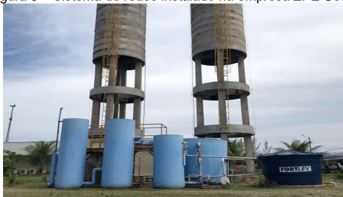
Figura 5 – Sistema de reuso instalado na empresa ZPE Ceará
