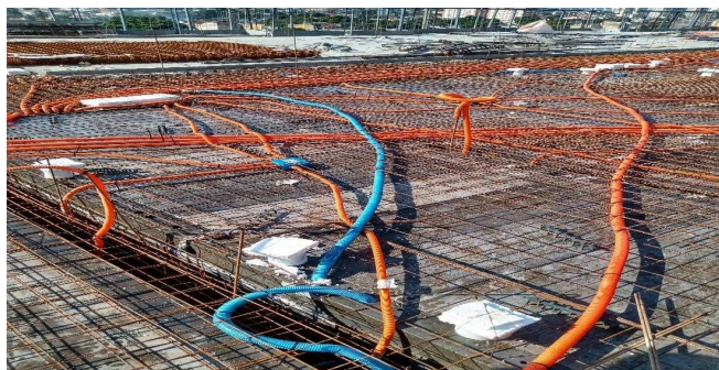
Figura 15 -Tubulação hidráulica pex
