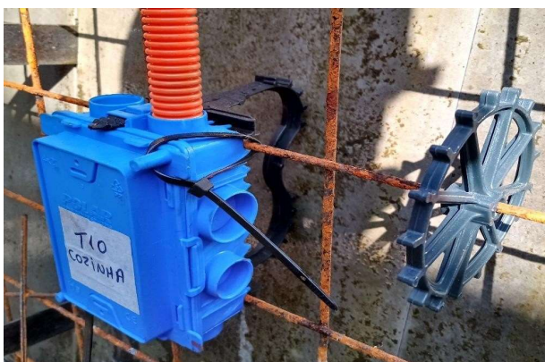
Figura 13- Caixa de passagem na parede
