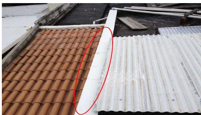
Figura 9 - Inconformidades no telhado
