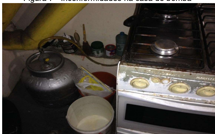
Figura 7 - Inconformidades na casa de bomba
