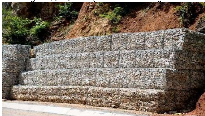
Figura 39 - Contenção com muro de gabiões
