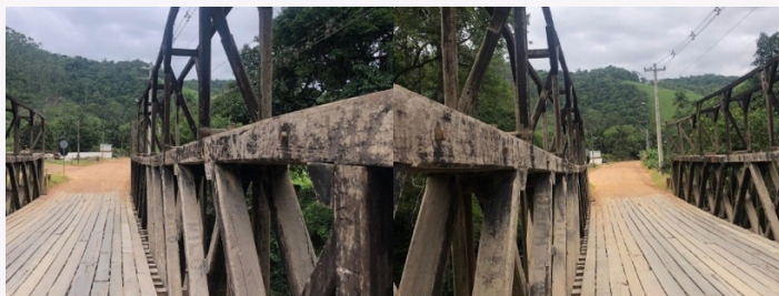
Imagem 05. D34. Visualização da evidência de flecha nas treliças (longarinas).
