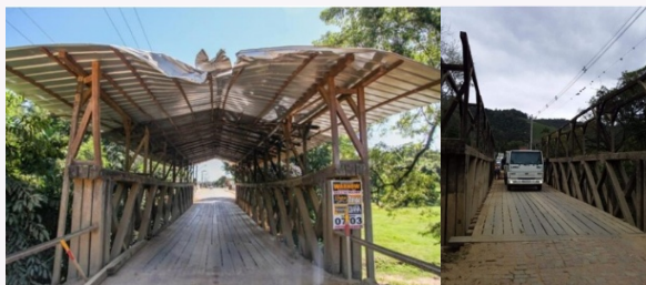
Imagem 03. Dano causado por veículo com excesso de altura em 2020.
