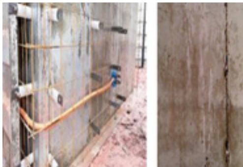
Figura 4. Exemplo de infiltrações
