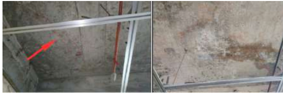
Figura 10 e 11: Exemplos de patologias encontradas- Fissura e Carbonatação
