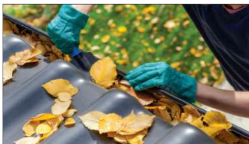
Figura 8: Acúmulo de detritos nas calhas.
