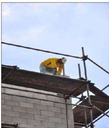
Figura 4: Trabalho em Altura com ausência de EPI
