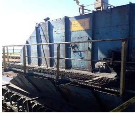
Figura 5: Casa de transferência de material (Shunts)
