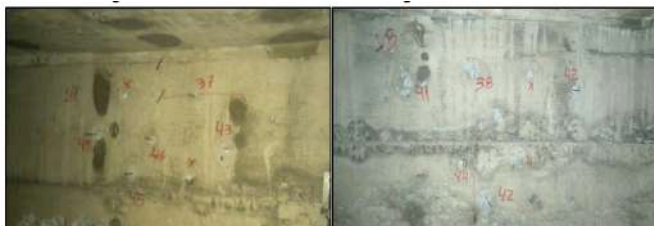
Figuras 14 e 15: Ponto 1A e 1B localizados na viga do teto do 1º subsolo
