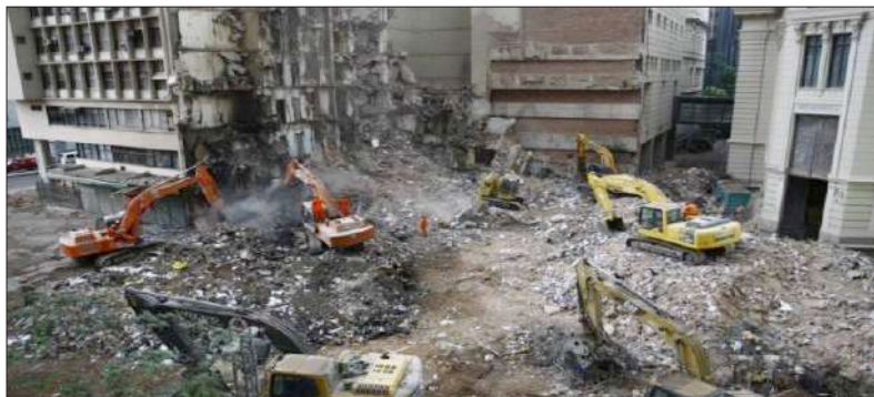
Figura 2: Local da tragédia. O terreno onde ficava o prédio, na Avenida Treze de Maio.
