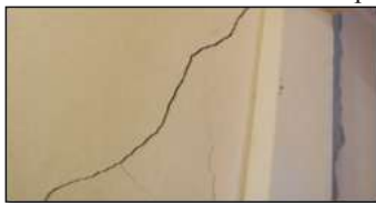
Figura 2: Fissuras e Rachaduras em parede
