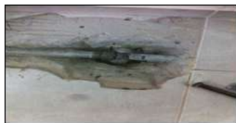
Figura 5: Vazamento de gás detectado após entrega do prédio
