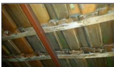
Figura 4: Infiltrações em telhados
