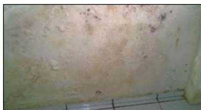
Figura 6: Infiltrações internas ocasionadas por vazamentos nas tubulações.
