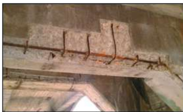
Figura 2: Desprendimento da cobertura da armadura de aço
