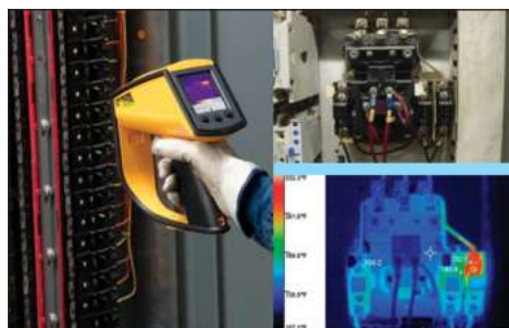
Figura 8: Imagem gerada por uma inspeção termográfica de um equipamento
