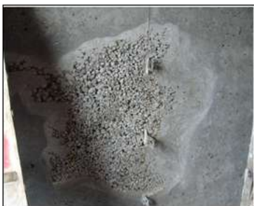
Figura 3: Segregação do concreto
