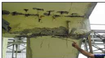
Figura 1: Degradação do concreto por má impermeabilização e pouca espessura revestindo as ferragens.
