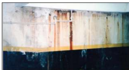
Figura 7: Infiltrações do lençol freático.
