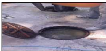
Figura 6: Entupimento por falta de limpeza regular do condomínio.
