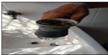
Figura 7: Sifão rígido em má conservação pelo cliente
