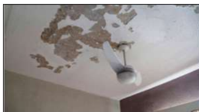
Figura 3: Infiltrações em lajes
