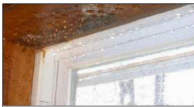
Figura 8: Infiltrações por condensação
