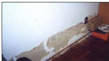
Figura 5: Infiltrações por capilaridade em paredes em contato direto com o solo
