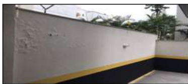
Figura 3: Infiltração em parede recém pintada
