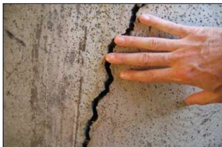
Figura 2: Rachaduras no concreto
