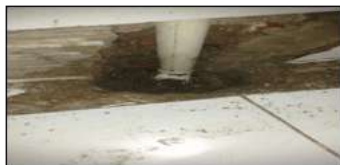
Figura 4: Tubulação com rompimento na junção do cano
