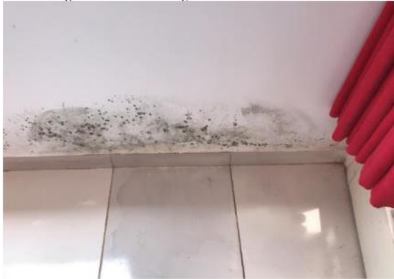
Figura 12: Manchas e fungos devido à umidade ascensional
