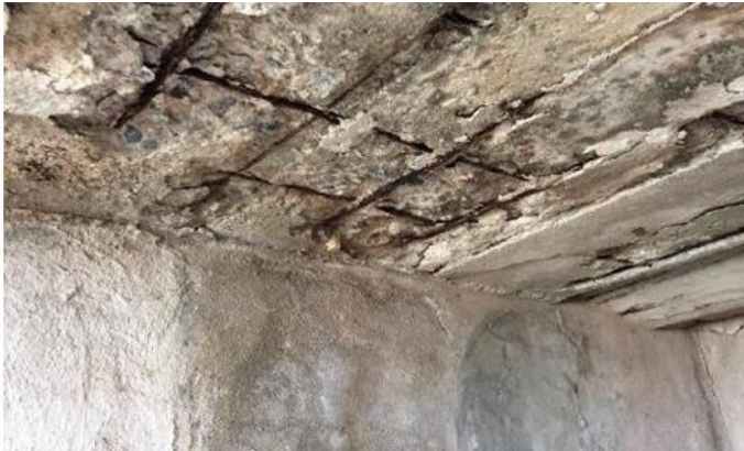
Figura 19: Corrosão de armaduras em fundo de caixa d'água.
