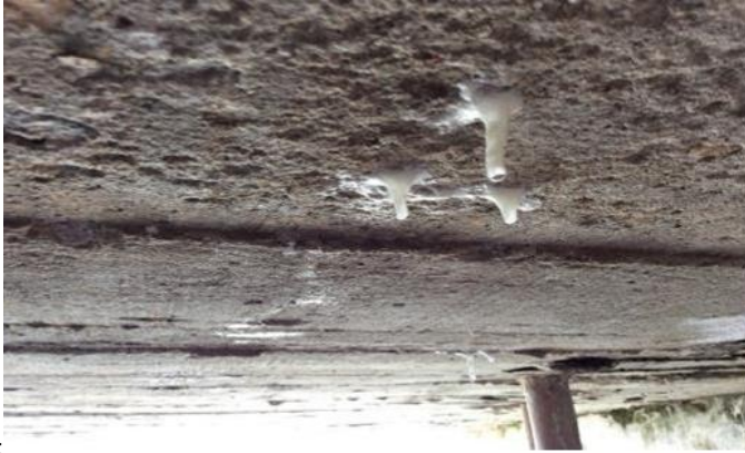
Figura 18: Estalactite em fundo de caixa d'água.
