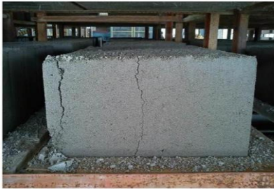
(c) Bloco fissurado
