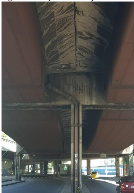
Figura 25 – Laje com lixiviação.
