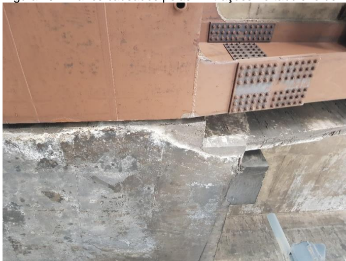
Figura 23 – Danos causados pelas infiltrações no tabuleiro devido a umidade.
