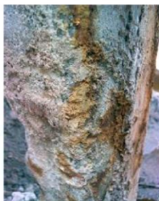
Figura 26 – Degradação apresentada em pilar de estrutura em contato com produtos químicos para fabricação de fertilizantes Foto: Maryangela Geimba de Lima, 1991
