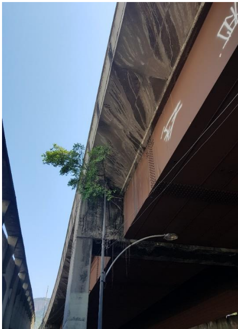
Figura 18 – Árvore crescendo entre a fenda.
