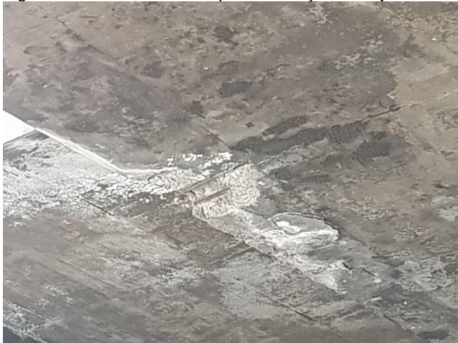
Figura 24 – Danos causados pelas infiltrações na laje devido a umidade.
