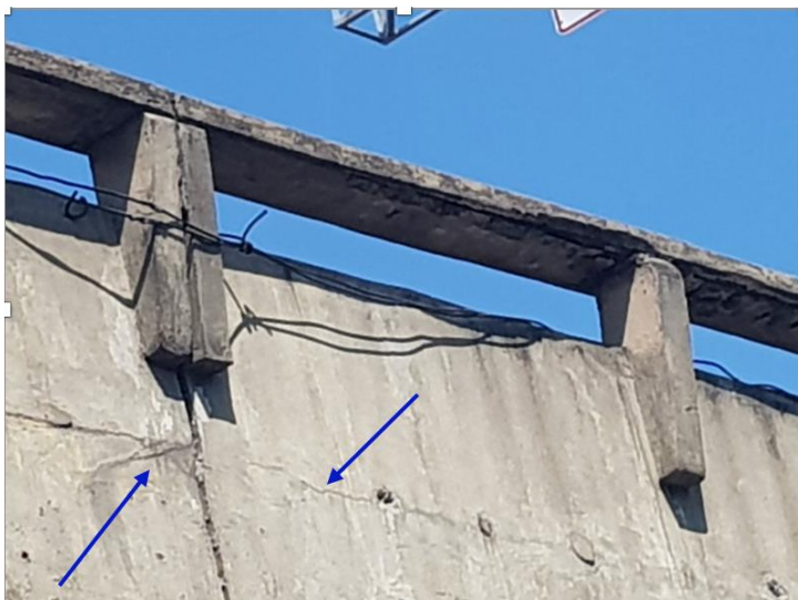
Figura 16 – Fissuras encontradas no guarda-corpo.
