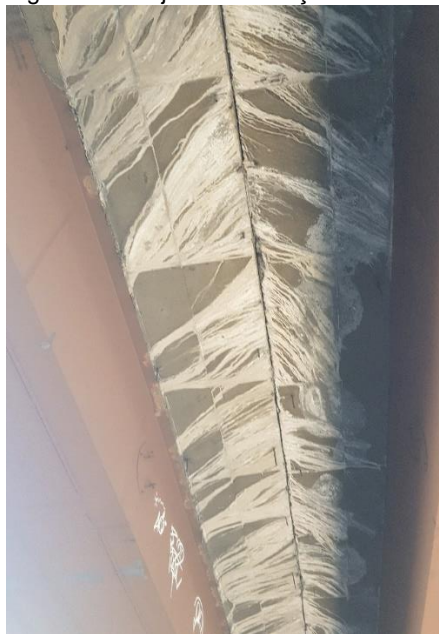
Figura 26 – Laje com lixiviação.
