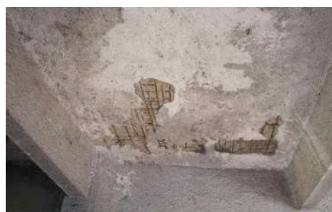
Figura 9 - Camada fina de cobrimento com deslocamento e exposição de armaduras
