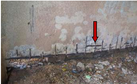
Figura 3 – Corrosão e cobrimento deslocado
