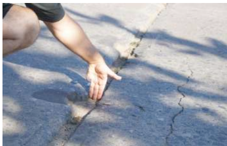
Figura 22–Juntas de dilatação fora dos padrões normativos
