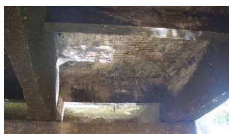
Figura 12 – Vigas: corrosão e perda parcial do aço
