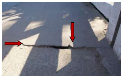
Figura 18 – Passeio: Trincas, fissuras e danos estéticos
