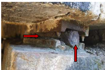
Figura 25–Aparelho de apoio apresentando corrosão
