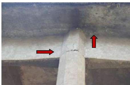
Figura 2 – Trincas, fissuras e esmagamento no encontro do pilar com a viga
