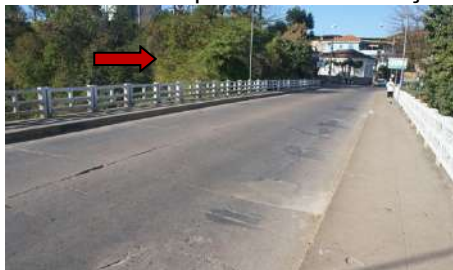
Figura 17 – Falta de pintura de sinalização
