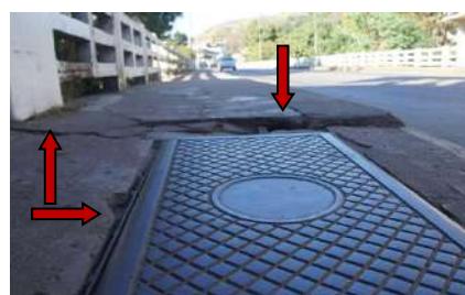
Figura 19 – Passeios: desnível das calçadas
