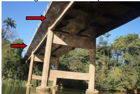
Figura 14 – Vigas: Armadura exposta e oxidada
