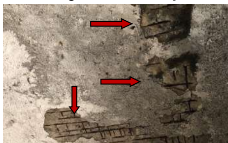
Figura 11 - Pilares: processo de corrosão e concreto e lixo agarrado na fundação.
