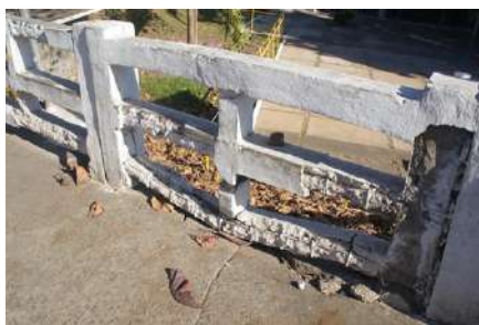
Figura 20 – Guarda-corpo: peças quebradas, armaduras expostas e oxidadas
