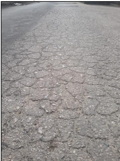
Figura 7: Rachaduras no pavimento da Av Euclides da Cunha - SJM
