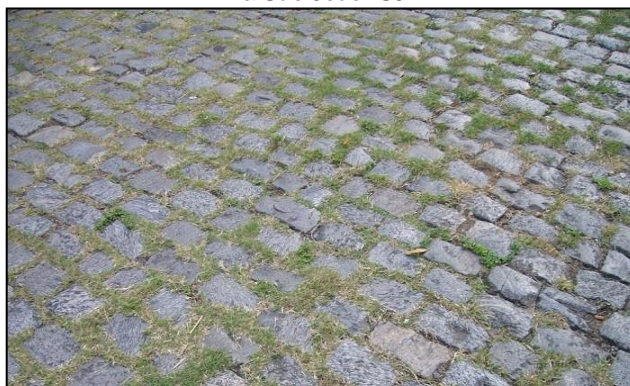
Figura 6: Pavimento de paralelepípedo com vegetação nas juntas – Rua Campos-Vila São João- SJM
