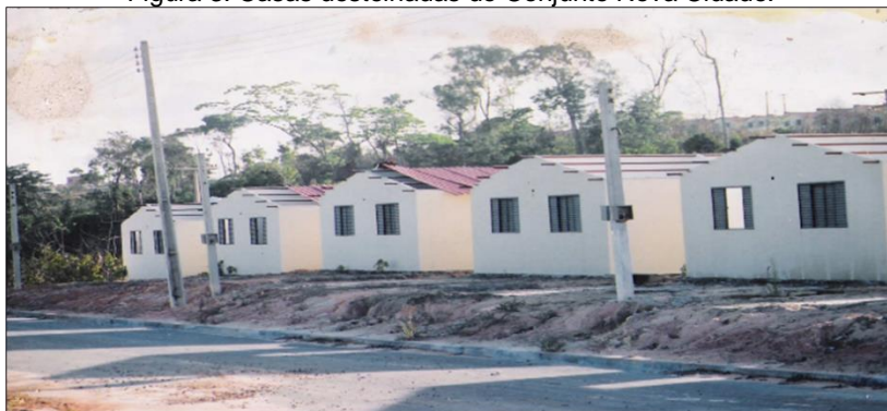
Figura 3: Casas destelhadas do Conjunto Nova Cidade.
