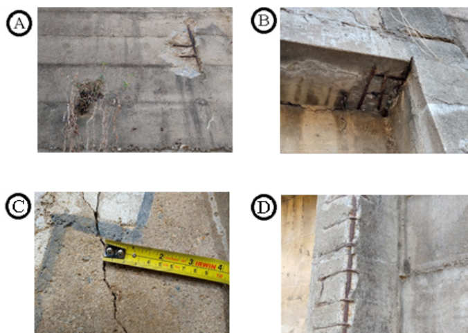
Figura 14 – Patologias do Muro 04: (A) Dreno obstruído e aço exposto; (B) Aço exposto; (C) Fissura; (D) Aço exposto.
