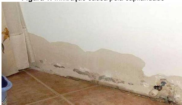
Figura 1: Infiltração causa pela capilaridade
