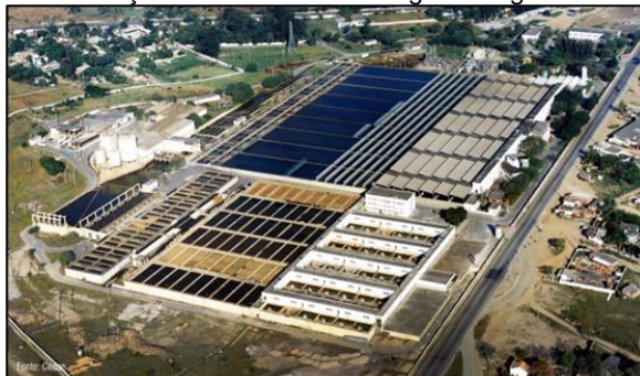
Figura 1: Estação de Tratamento de água e esgoto do Guandu
