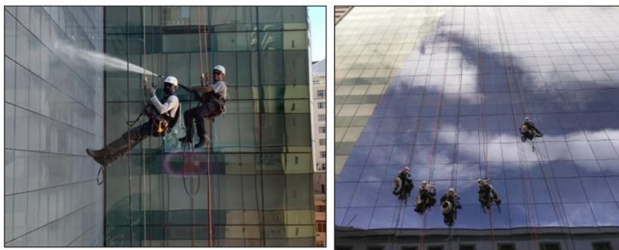
Figura 10 e 11: Realização do teste de estanqueidade na fachada do setor 2, seguida da impermeabilização do perímetro onde apresentou infiltrações após o teste.
