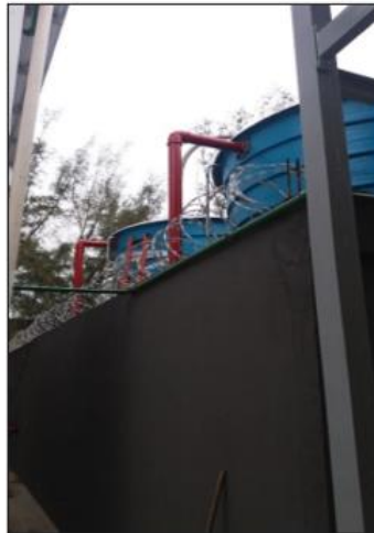
Figura 6: Reservatório de Apoio
