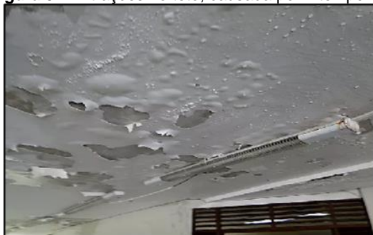
Figura 5: Infiltrações no teto, causada por Intempéries
