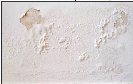
Figura 4: Parede com descamação causada por Infiltração.
