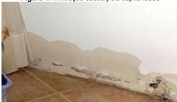
Figura 1: Infiltração causa pela capilaridade
