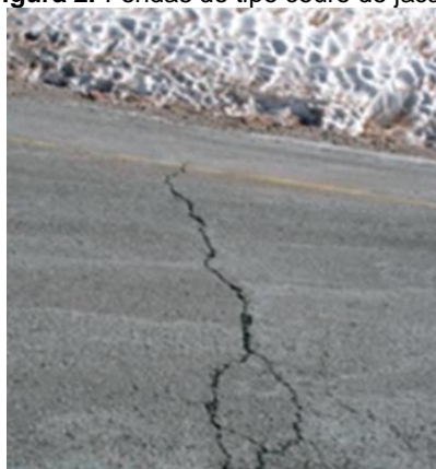
Figura 2: Fendas do tipo couro de jacaré
