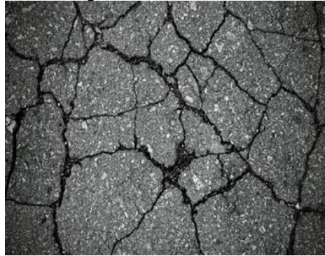
Figura 4: Trinca em bloco
