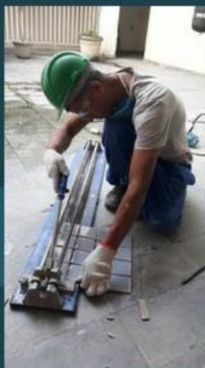
Corte de piso com riscador
