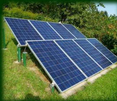
Placa Solar fotovoltaica
